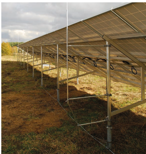
Bild 2 Blitzschutz mit DEHNiso-Befestigungshalter
