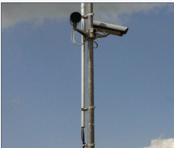
Bild 4 HVI-Leitung am Mast installiert
