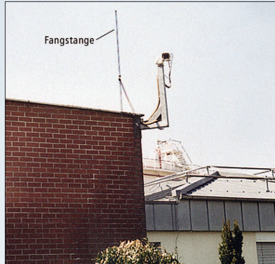
Bild 2 Überwachungskamera im Schutzbereich einer Fangstange
