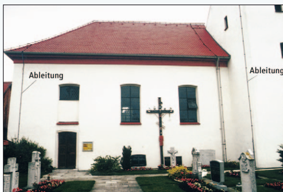
Bild 1 Äußerer Blitzschutz des Kirchenschiffs
