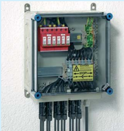
2 Überspannungsschutz im Generatoranschlusskasten des PV-Generators
