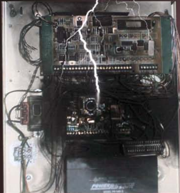
Durch Gewittereinwirkung zerstörte Gefahrenmeldeanlage
