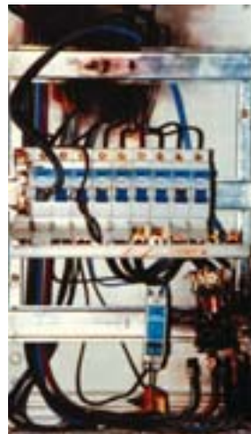
Bild 8.1.3.1 Durch Blitzstoßstrom zerstörter RCD
