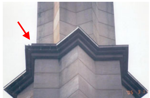
Fig. 7: Primer plano de la sección del minarete dañada por el rayo (señalada por la flecha).
