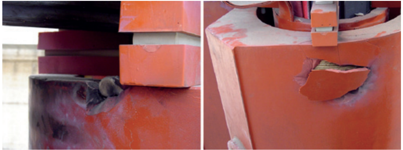
Bild 2: Defekter Trafo durch direkten Blitzeinschlag
