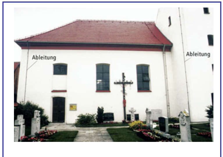
Bild 1: Äußerer Blitzschutz des Kirchenschiffs
