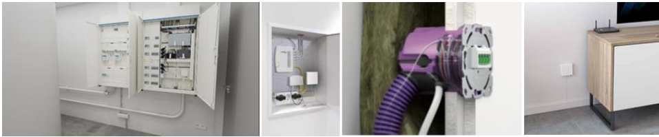
Abbildung 16: Quelle: Kaiser, Schalksmühle - Fachausschuss Elektro- und Informationstechnische Gebäudeinfrastruktur (EIG), Berlin
