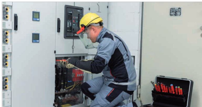
Bild 4. Elektrofachkraft bei der Arbeit an einer Niederspannungsschaltanlage
