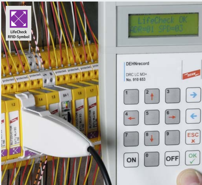
Überprüfung eines Ableiter-Moduls mit RFID-Technik (LifeCheck)
